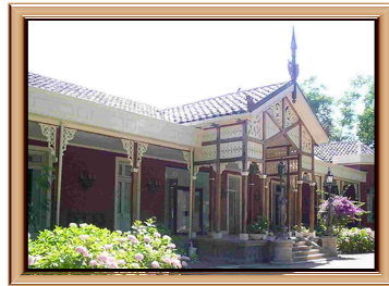
Casa de la Cultura Manuel Magallanes Moure seriamente dañada por el terremoto del año 2010. La casa y el Parque García de la Huerta fueron adquiridos por la Ilustre Municipalidad en 1987, siendo Alcaldesa Cristina Salas.
